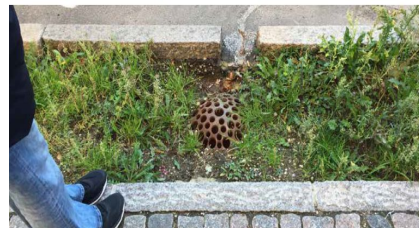
Aiuole per infiltrazione
